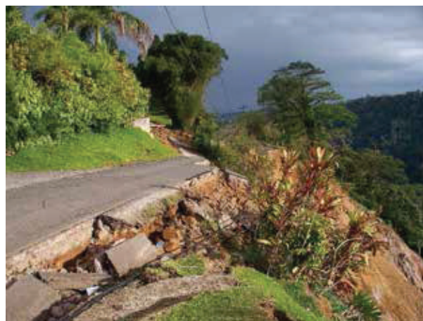
Figura 1. Daños en la vía en Cinchona. Fuente: CNE, 2009
